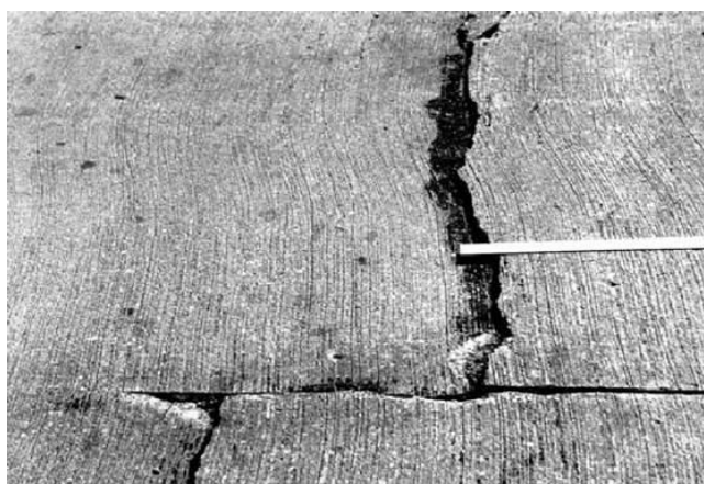
Fig. X2.24 Fisura Lineal – Alta Severidad
