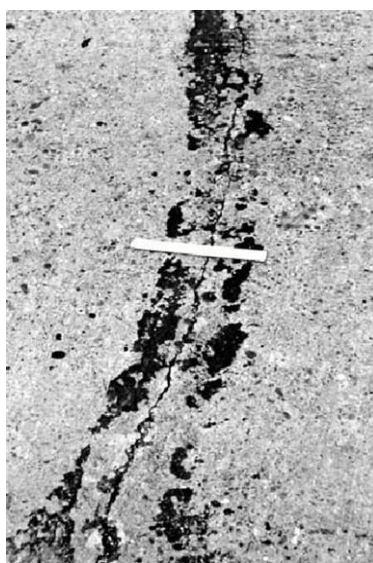
Fig. X2.22 Fisura Lineal – Baja Severidad
