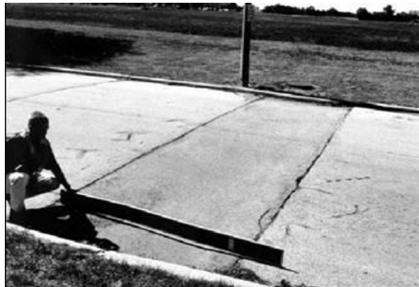
Fig. X1.32 Parches y Parches de Cortes Utilitarios – Mediana Severidad
