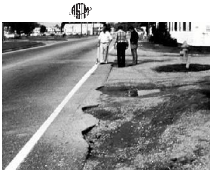
Fig. X1.21 Fisura de Borde – Alta Severidad
