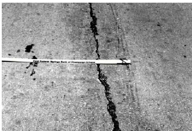
Fig. X2.23 Fisura Lineal – Mediana Severidad
