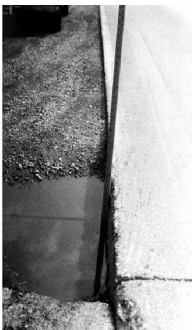
Fig. X2.21 Desnivel Carril-Berma – Alta Severidad
