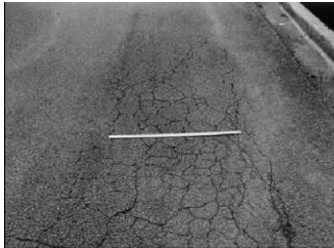
Fig. X1.2 Piel de Cocodrilo – Mediana Severidad
