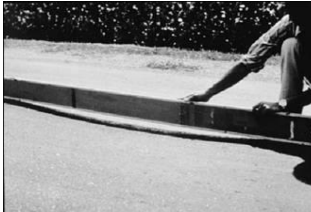
Fig. X1.17 Depresión – Mediana Severidad
