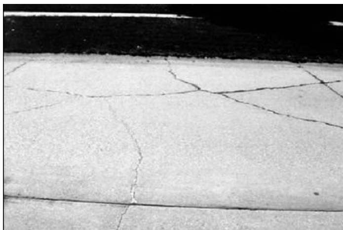
Fig. X2.8 Losa Dividida – Mediana Severidad
