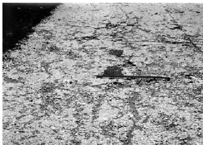
Fig. X2.43 Descascaramiento, Mapa de Fisuras, Craquelado – Alta Severidad
