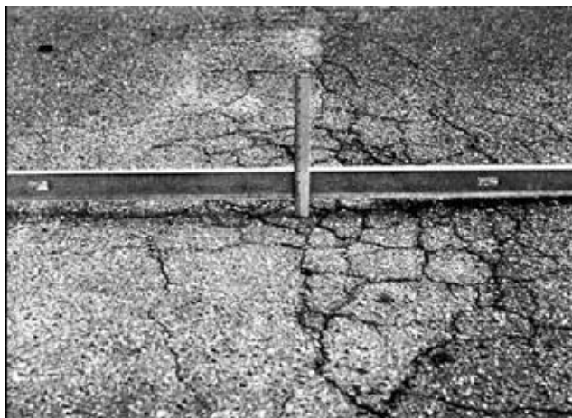
Fig. X1.18 Depresión – Alta Severidad
