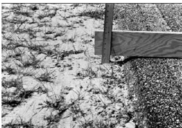
Fig. X1.25 Desnivel Carril-Berma – Baja Severidad
