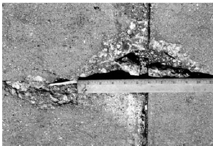
Fig. X2.46 Descascaramiento de Esquina – Mediana Severidad
