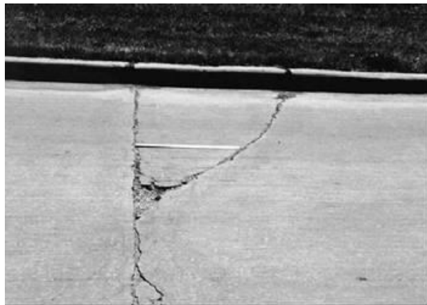
Fig. X2.5 Fractura de Esquina – Mediana Severidad
