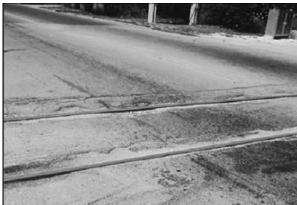
Fig. X1.39 Cruce de Vía Férrea – Mediana Severidad
