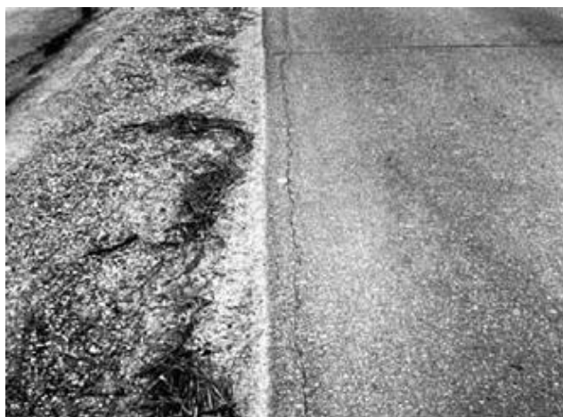
Fig. X1.19 Fisura de Borde – Baja Severidad
