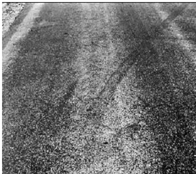
Fig. X1.4 Exudación – Baja Severidad
