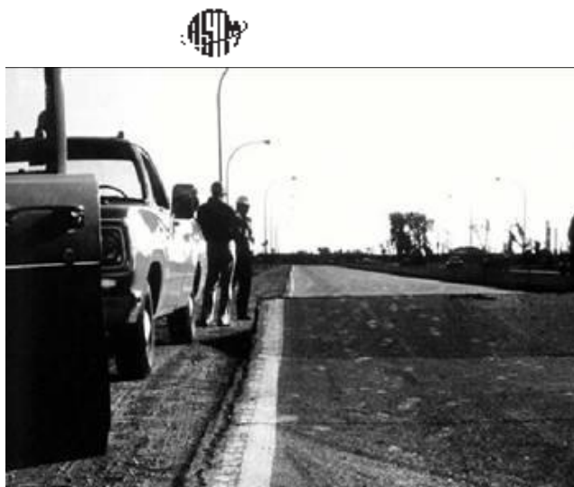
Fig. X2.3 Levantamiento/Pandeo – Alta Severidad
