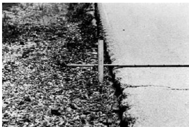
Fig. X1.27 Desnivel Carril-Berma – Alta Severidad
