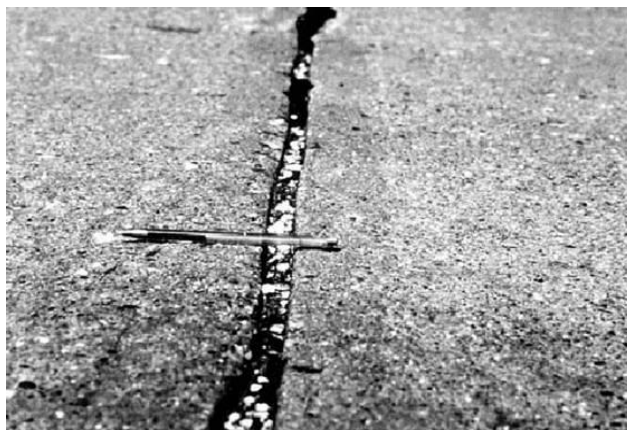
Fig. X2.18 Daño en el Sello de la Junta – Alta Severidad
