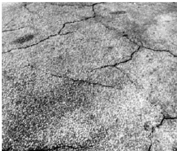
Fig. X1.9 Fisuras en Bloque –Alta Severidad
