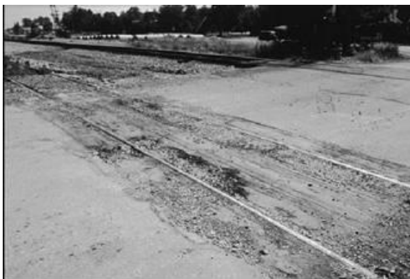
Fig. X1.40 Cruce de Vía Férrea – Alta Severidad
