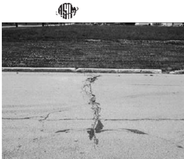
Fig. X1.30 Fisura Longitudinal y Transversal –Alta Severidad
