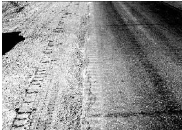
Fig. X1.22 Fisura de Reflexión de Junta – Baja Severidad
