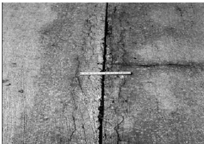
Fig. X2.10 Fisura de Durabilidad – Baja Severidad
