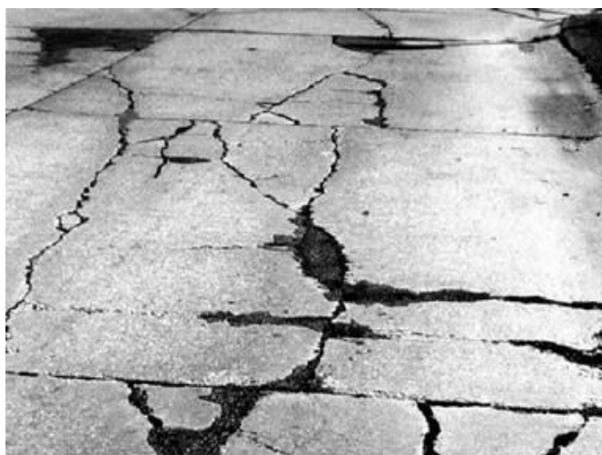
Fig. X2.9 Losa Dividida – Alta Severidad
