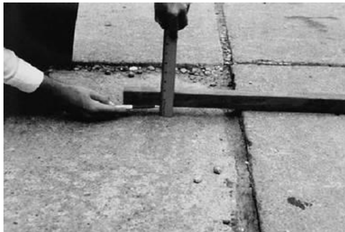
Fig. X2.15 Escalonamiento – Mediana Severidad
