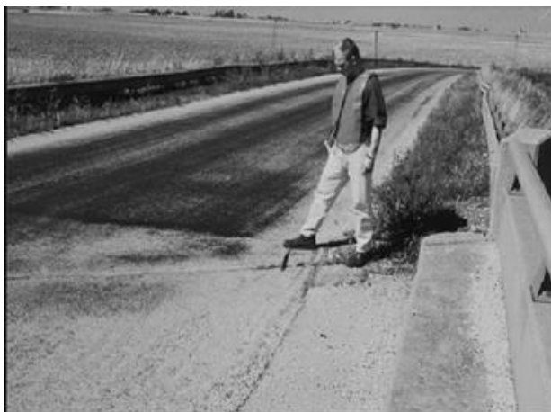
Fig. X1.44 Desplazamiento – Baja Severidad
