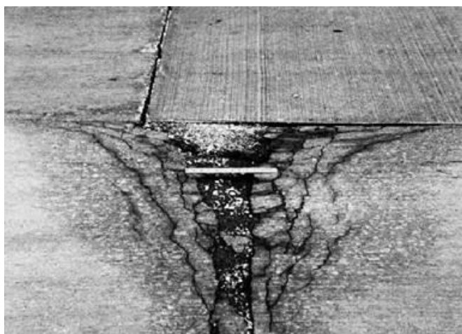
Fig. X2.11 Fisura de Durabilidad – Mediana Severidad
