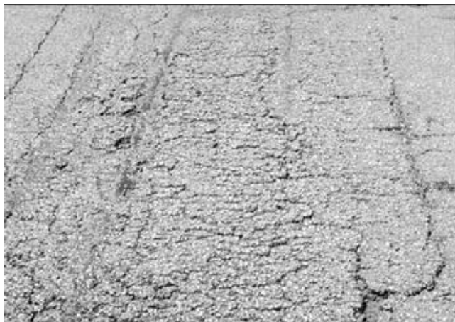
Fig. X1.52 Peladura por Intemperismo y Desprendimiento de Agregados – Mediana Severidad
