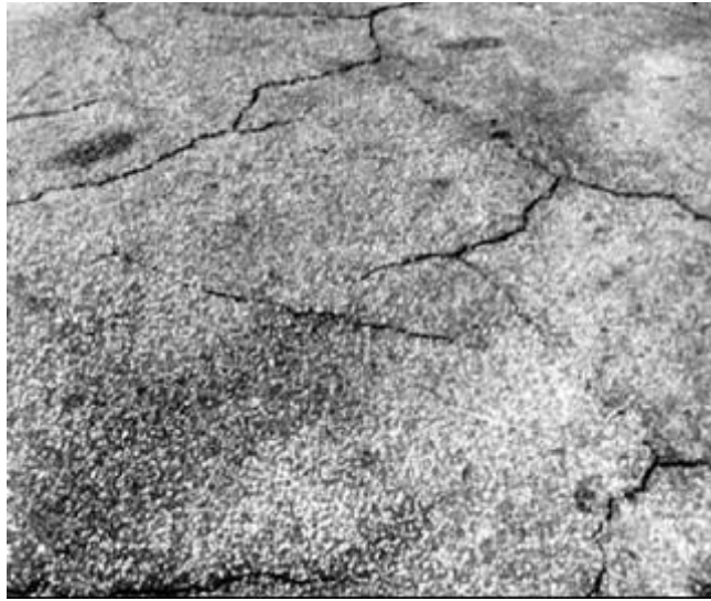
Fig. X1.10 Abultamientos y Hundimientos – Baja Severidad
