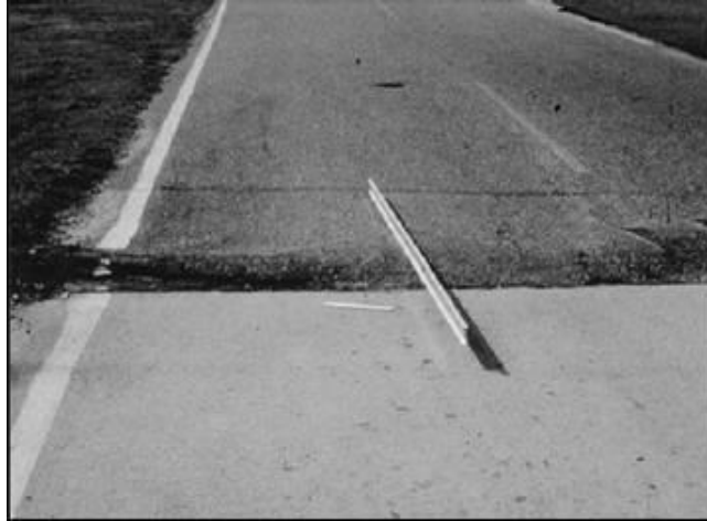
Fig. X1.47 Fisura Parabólica o por Deslizamiento – Baja Severidad
