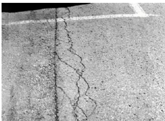
Fig. X1.20 Fisura de Borde – Mediana Severidad
