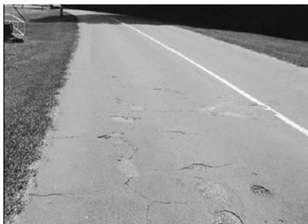
Fig. X1.53 Peladura por Intemperismo y Desprendimiento de Agregados – Alta Severidad
