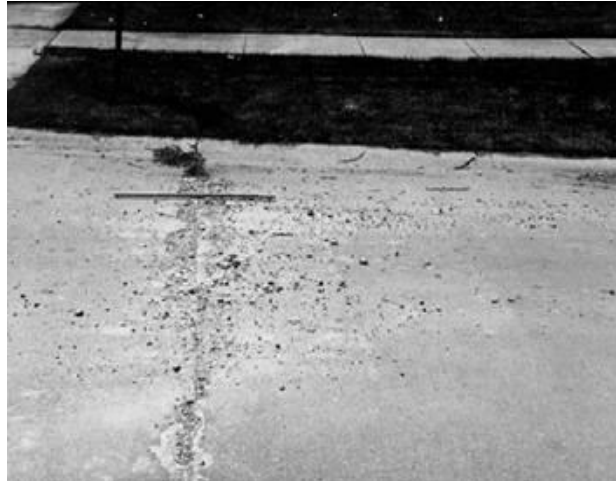
Fig. X2.1 Levantamiento/Pandeo – Baja Severidad
