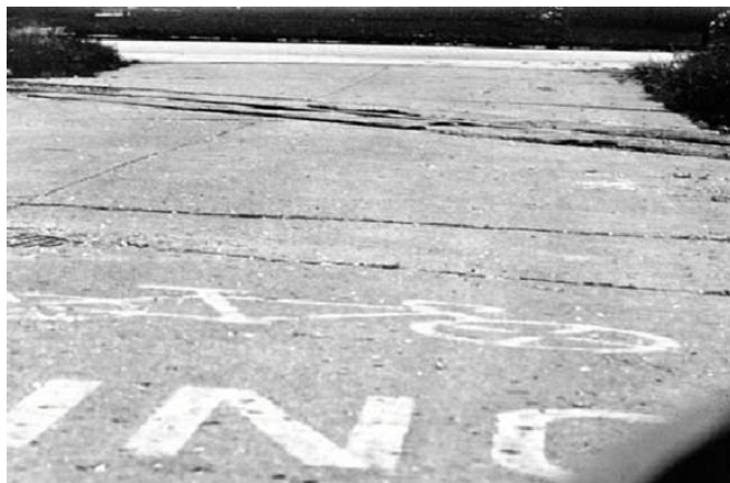
Fig. X2.39 Cruce de Vía Férrea – Mediana Severidad
