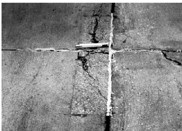
Fig. X2.30 Parches Pequeños – Alta Severidad
