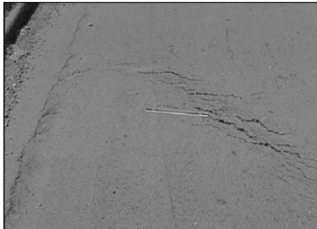
Fig. X1.48 Fisura Parabólica o por Deslizamiento – Mediana Severidad
