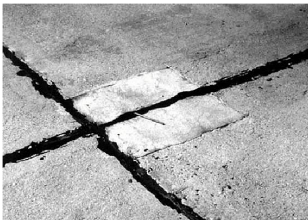
Fig. X2.28 Parches Pequeños – Baja Severidad
