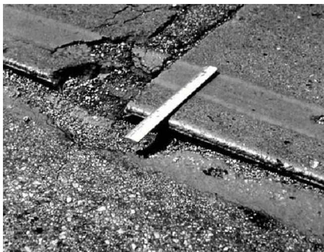
Fig. X2.19 Desnivel Carril-Berma – Baja Severidad
