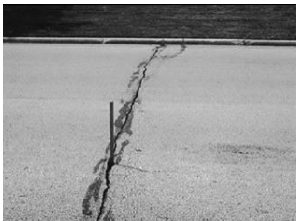
Fig. X1.29 Fisura Longitudinal y Transversal – Mediana Severidad
