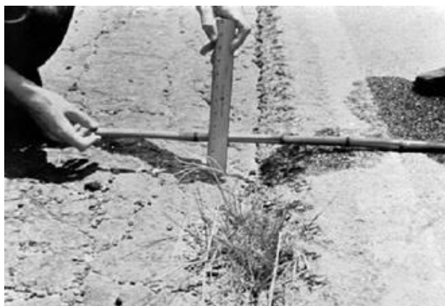
Fig. X1.26 Desnivel Carril-Berma – Mediana Severidad
