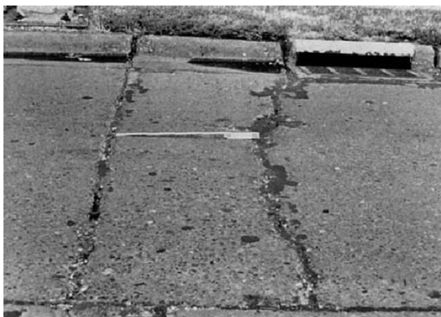
Fig. X2.35 Punzonamiento – Baja Severidad
