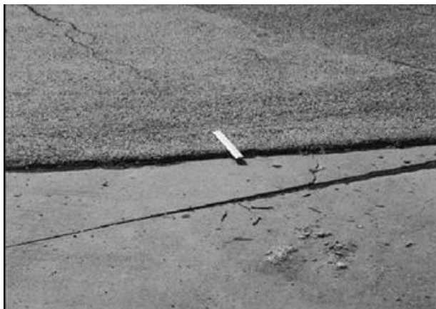
Fig. X1.45 Desplazamiento – Mediana Severidad
