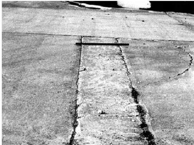
Fig. X2.26 Parches Grandes y Acometidas de Servicios Públicos –Mediana Severidad
