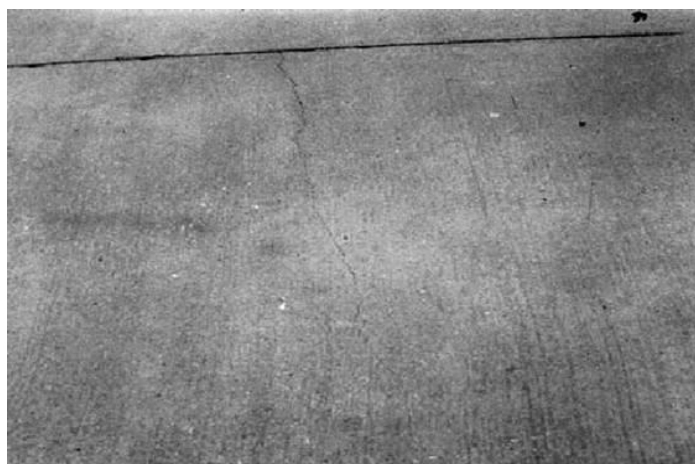
Fig. X2.44 Fisuras de Contracción
