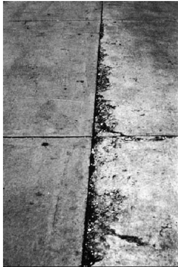
Fig. X2.49 Descascaramiento de Junta – Mediana Severidad
