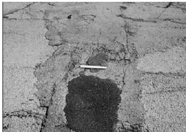
Fig. X1.33 Parches y Parches de Cortes Utilitarios – Alta Severidad
