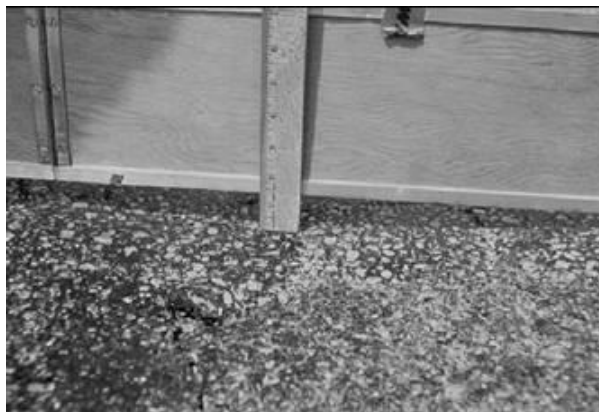
Fig. X1.43 Ahuellamiento – Alta Severidad
