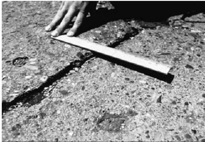
Fig. X2.14 Escalonamiento – Mediana Severidad
