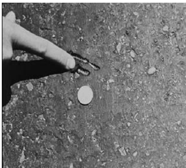
Fig. X1.5 Exudación – Mediana Severidad
