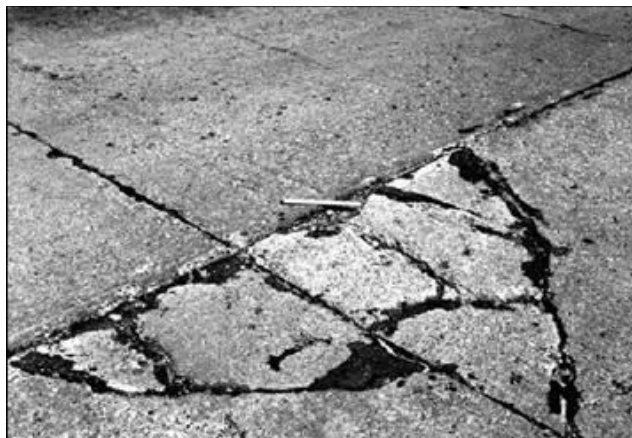
Fig. X2.6 Fractura de Esquina – Alta Severidad
