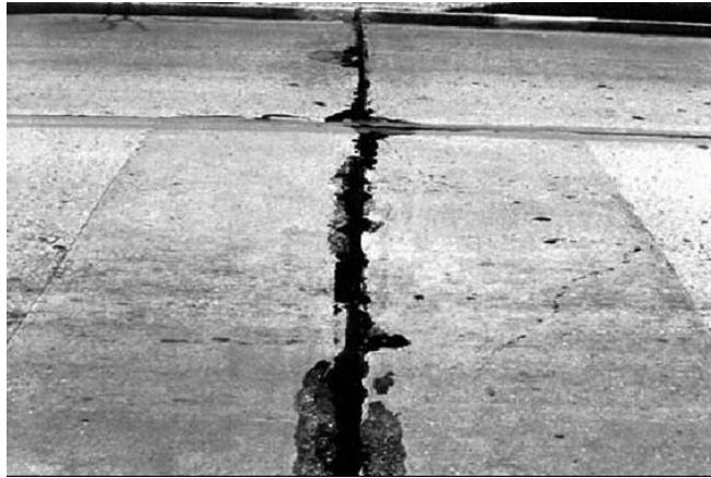
Fig. X2.16 Daño en el Sello de la Junta – Baja Severidad
