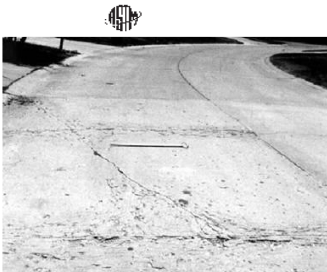
Fig. X2.12 Fisura de Durabilidad – Alta Severidad
