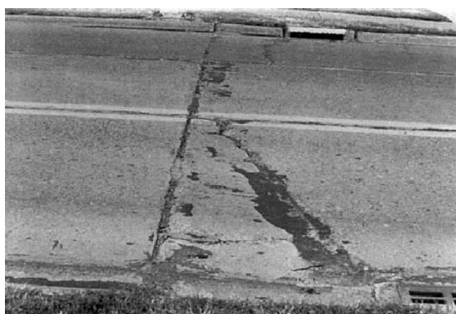
Fig. X2.36 Punzonamiento – Mediana Severidad
