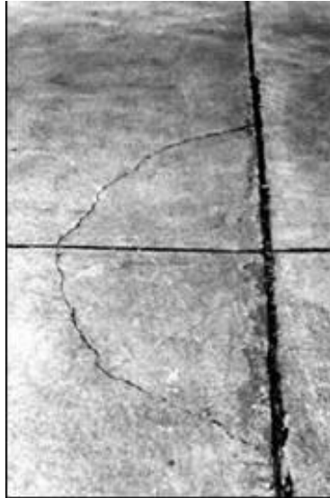
Fig. X2.4 Fractura de Esquina – Baja Severidad
