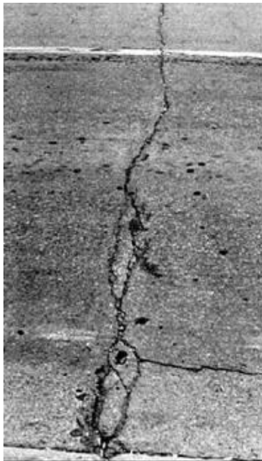
Fig. X1.23 Fisura de Reflexión de Junta – Mediana Severidad
