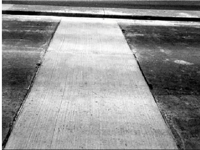
Fig. X2.25 Parches Grandes y Acometidas de Servicios Públicos – Baja Severidad
