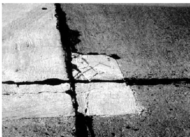
Fig. X2.29 Parches Pequeños – Mediana Severidad
