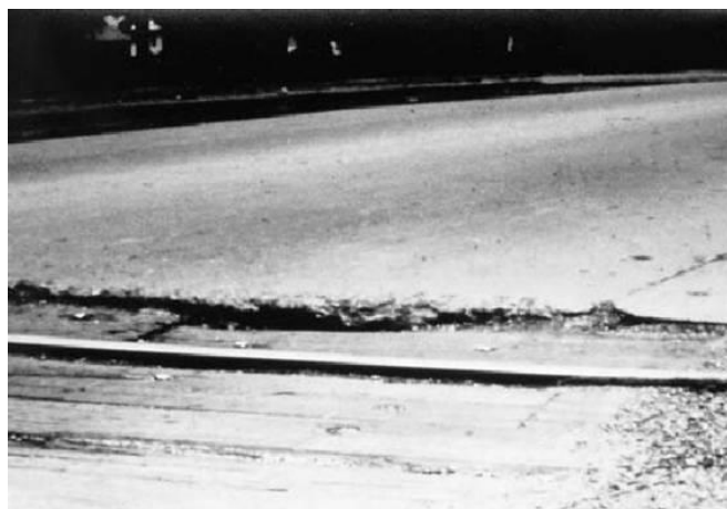
Fig. X2.40 Cruce de Vía Férrea – Alta Severidad
